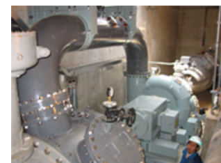
【水力発電設備】
