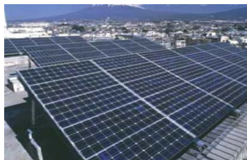
【太陽光発電設備】
