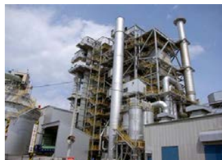
【バイオマス発電設備】
